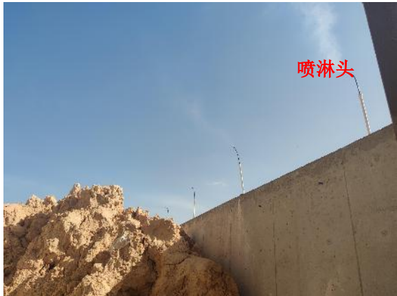
降尘喷淋装置
