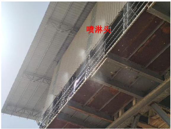
降尘喷淋装置
