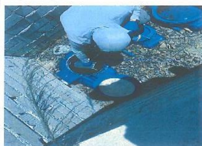
化粪池出水口 (第四次)
