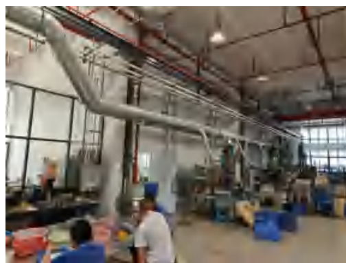
废气收集后集中到排烟管道
