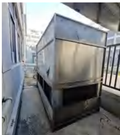
循环冷却水池
