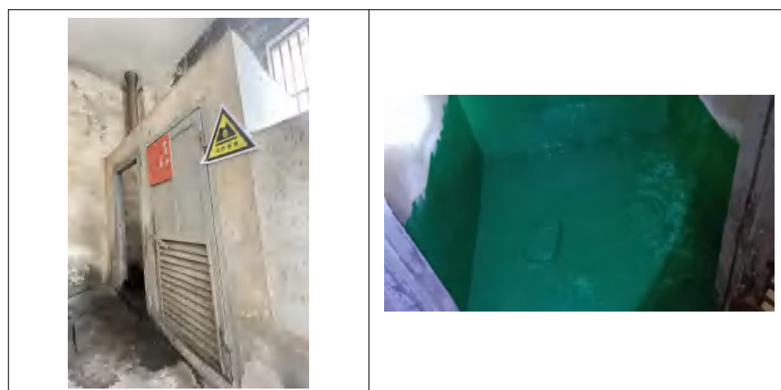
图 3-3 危险废物暂存间
