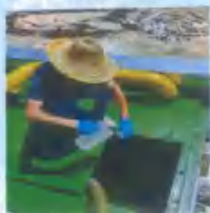
W1 污水进水口
