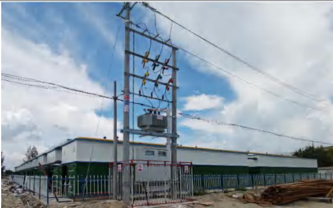
一体化处理设施
